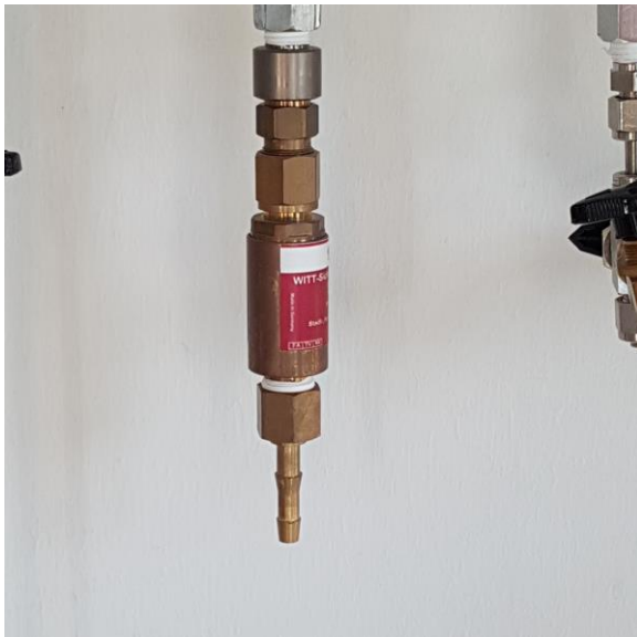
Figur 4 Tilbageløbsventil på acetylenforsyningen
